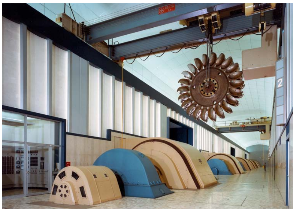
Alstom verfügt im Bereich der Modernisierung bestehender Kraftwerksanlagen über ein breites Know-how. Bild: Alstom
